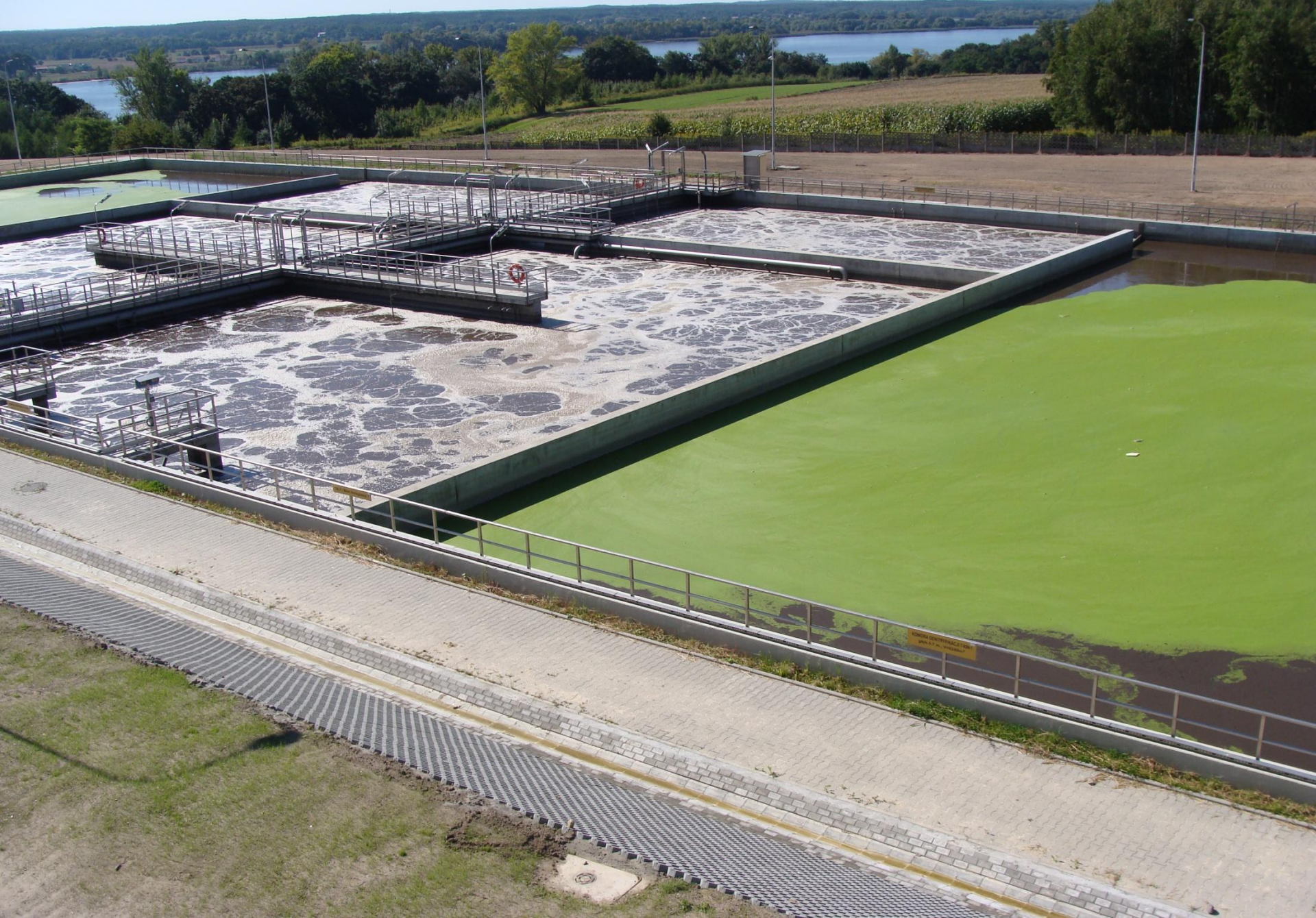
Nowy blok biologiczny - komory nitryfikacji i denitryfikacji
