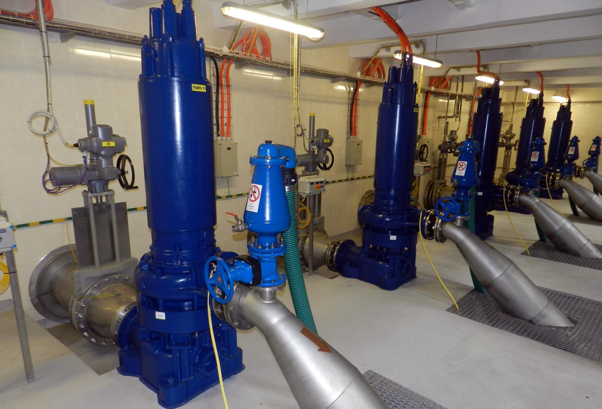
Hala pomp przy ul. Jasnej – po modernizacji
