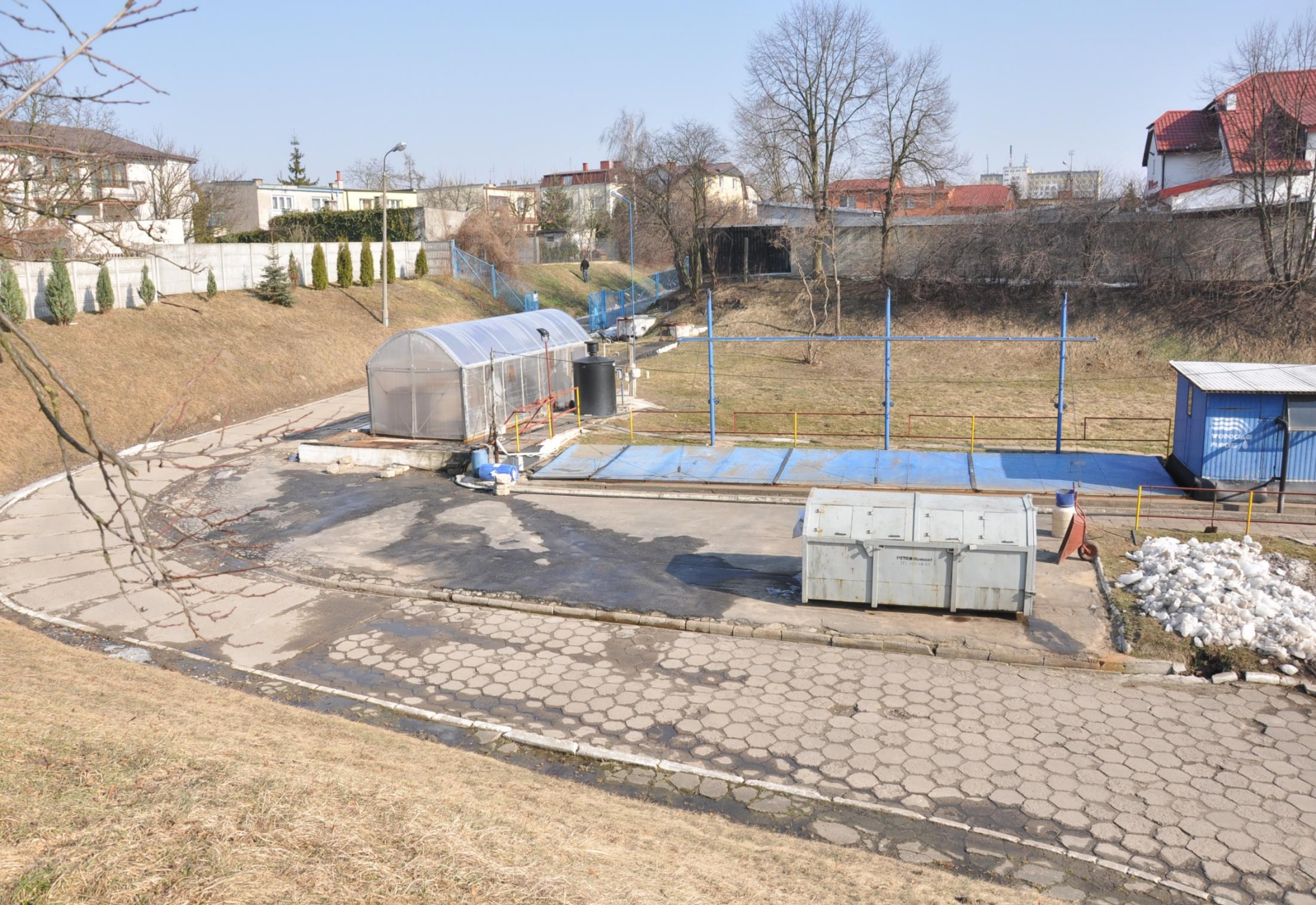
Przepompownia ścieków przy ul. Jasnej – przed modernizacją
