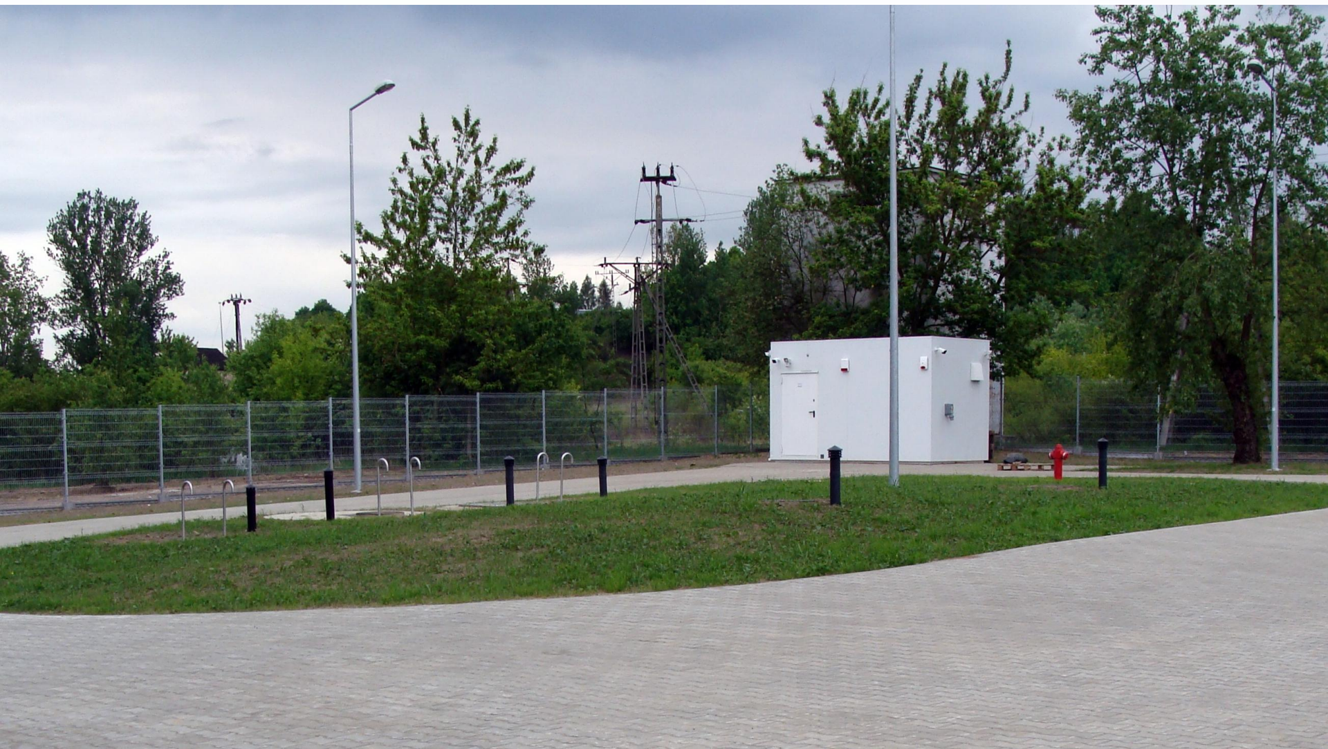
Przepompownia ścieków w Górzach, 2015 r.
