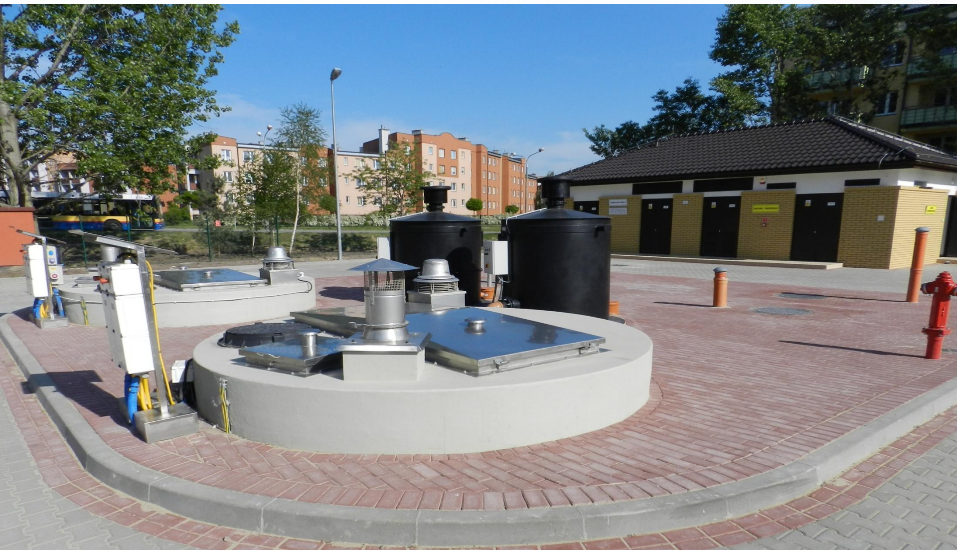
Przepompownia ścieków P5 przy ul. Mazura – po modernizacji
