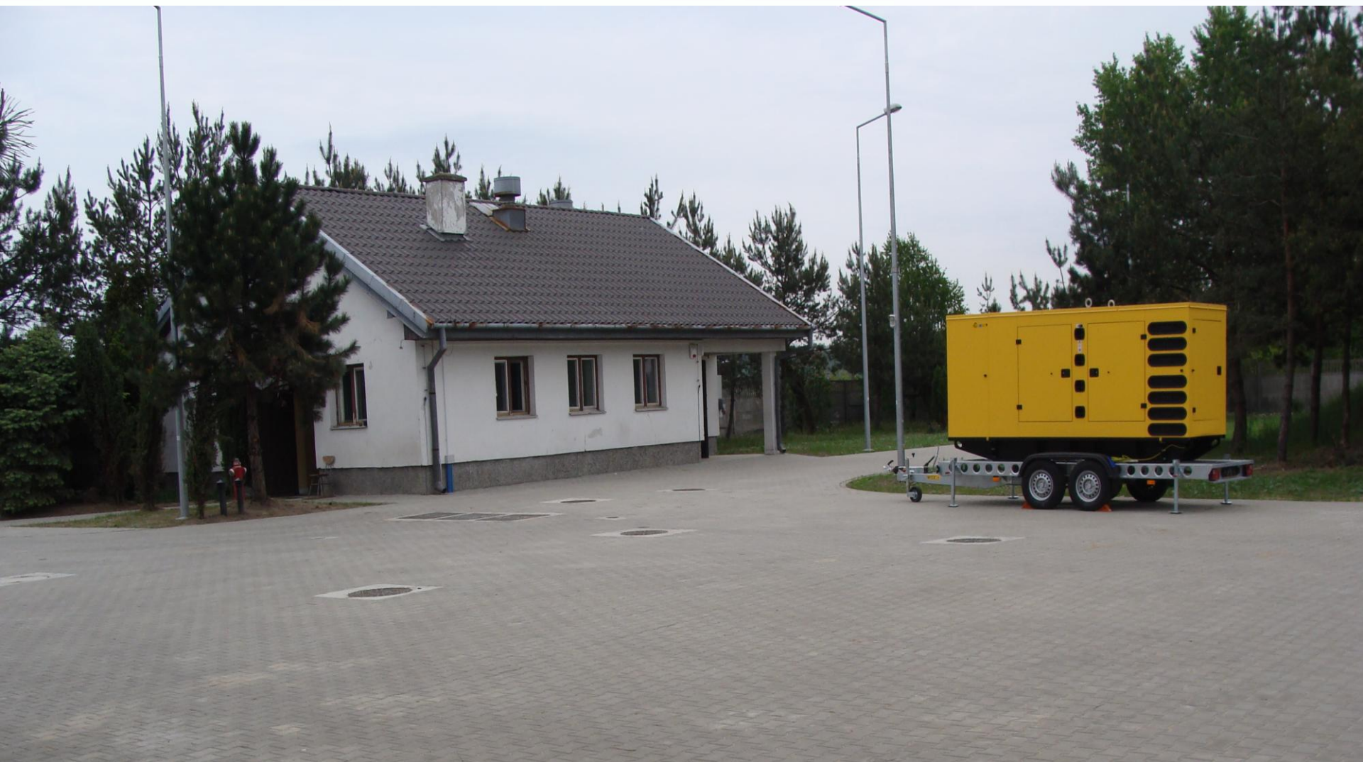
Przepompownia ścieków w Radziwiu, 2015 r.
