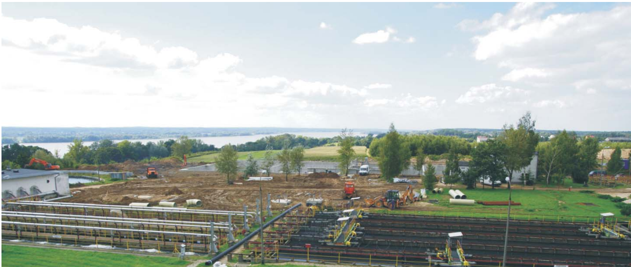
Oczyszczalnia ścieków w Maszewie
