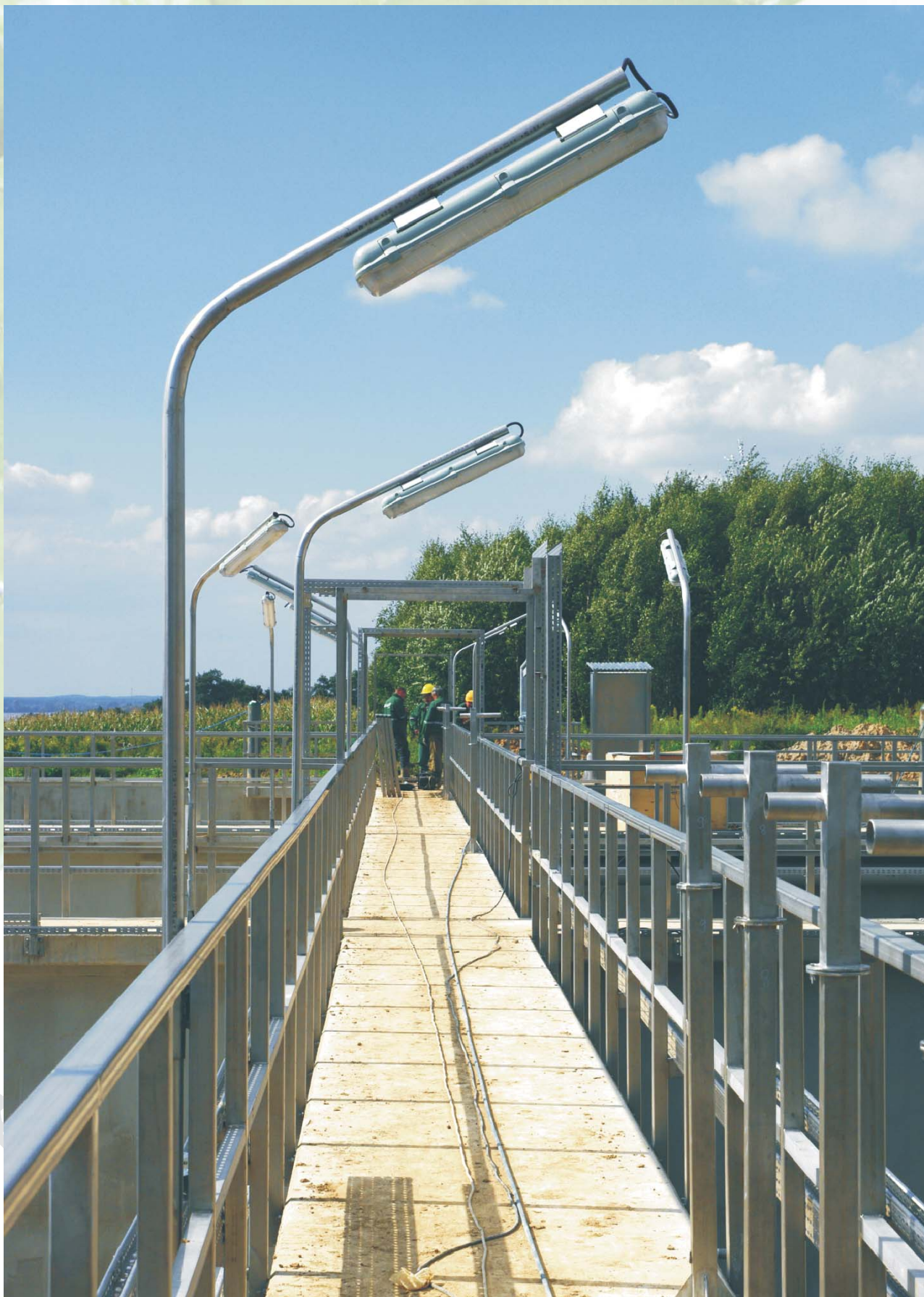
Oczyszczalnia ścieków w Maszewie
