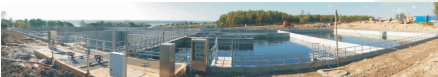
Oczyszczalnia ścieków w Maszewie - komory denitryfikacji, zmienne oraz nityfikacji.
