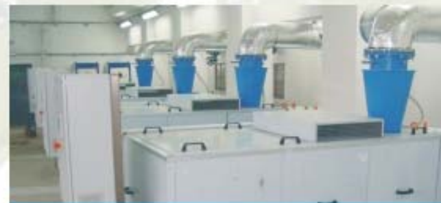
Oczyszczalnia ścieków w Maszewie – stacja dmuchaw.
