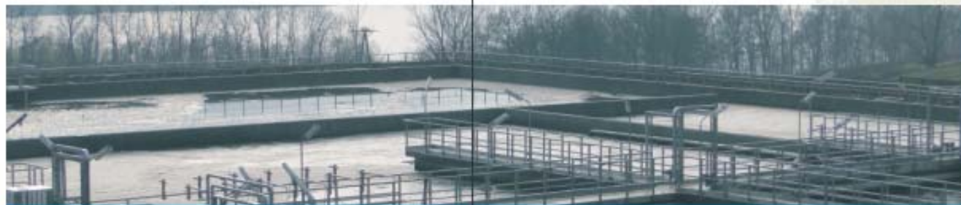
Oczyszczalnia ścieków w Maszewie – kolumny denitryfikacji, zmienne oraz nityfikacji.
