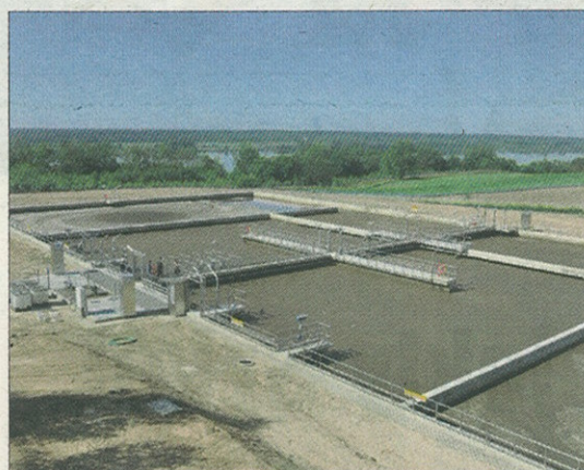
Część biologiczna oczyszczalni w Maszewie – komory denitryfikacji, zmienne oraz nitrifikacji
